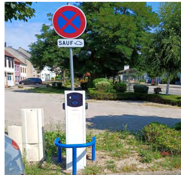
Autre équipement bien pratique : la borne de rechargement pour voiture électrique
